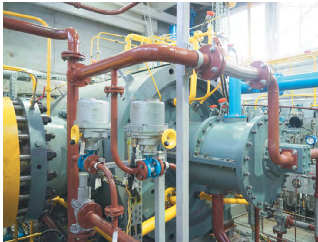
Газоперекачивающие агрегаты – «сердце» компрессорной станции
